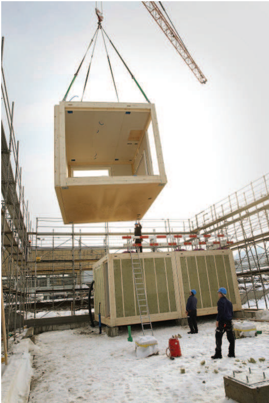
Mit Feingefühl platziert: 42 Module werden in Niederwangen zu einem Schulhaus zusammengebaut. Urs Baumann
